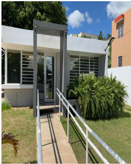
Cuando llueve el agua entra al interior de la casa por desnivel en el interior y exterior del terreno
