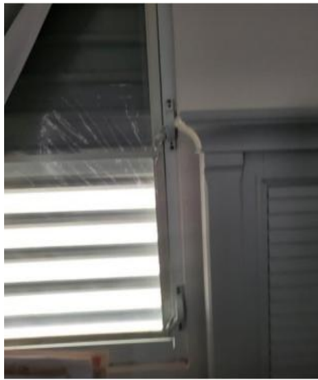
Operadores no funcionan
