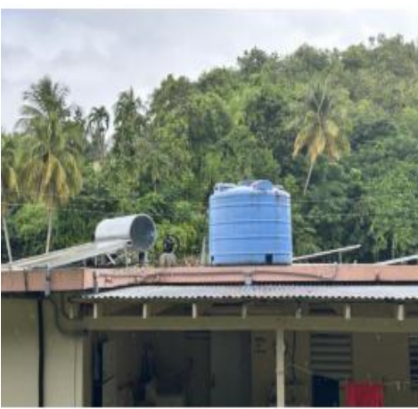
Calentador solar no funciona desde instalación
