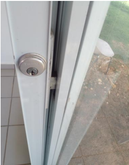
Puerta no abre hacia el exterior
