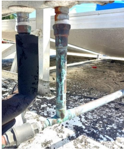
Filtraciones del calentador solar
