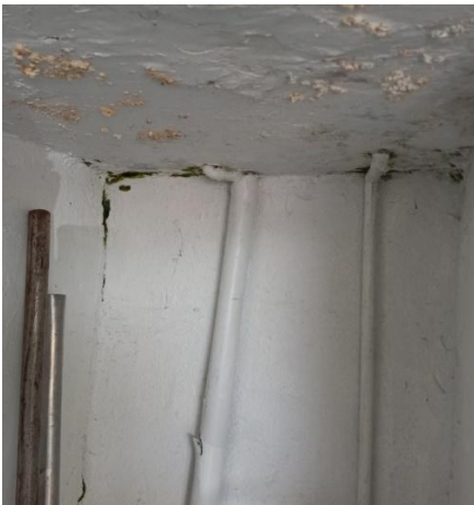
Filtración en techo de closet de marquesina
