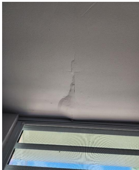
Parte del empañetado de techo se desprendió
