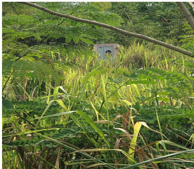
Caja de conexión eléctrica
